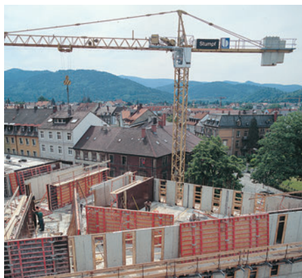
Oplata širine 9 m i visine 2,70 m u celini prekrivena oblogom za profilisanje površine betonskih elemenata.
