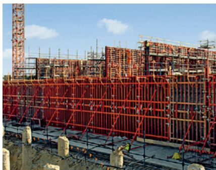
Stacja uzdatniania wody Kurnell, Sydney, Australia
