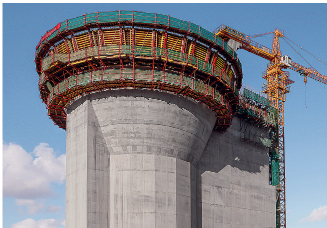
大型コンクリート・オーバーフロー・ファンネル（漏斗）のためのSCSクライミング・ブラケット上のフリーフォーム型枠。
