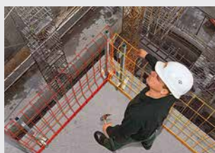
Sistemas de Seguridad
